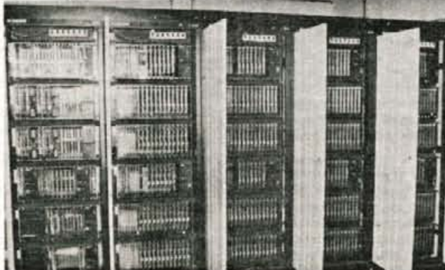
Iskrina digitalna ATC SI 2000 v Bitnjah ima 2304 priključke in 120 spojin vodov po optičnem digitalnem sistemu...
