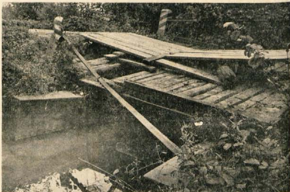
Če ne bi prebivalci Tenetiš na ostanke starega mostu pribili nekaj plohov, bi bila struga neprehodna. — Foto: F. Perdan
