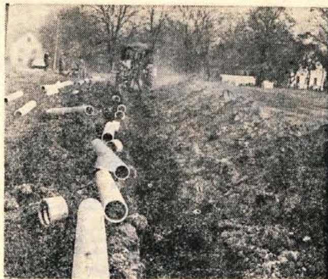
Pred dnevi so delavci gradbenega podjetja Tehnik Skofja Loka in podjetja SIGMA (Savinjska industrija gradbene montaže) začeli napeljevati 3800 metrov dolg cevovod, priključek novega vodovoda Hotovlje—Skofja Loka, ki bo oskrboval z vodo prebivalce vasi Virmaše, Sv. Duh, Forme in Dorfarje. Del potrebnega denarja za gradnjo (310 tisoč din) so zbrali ljudje s samopriskom, ostalo pa bodo opravili s prostovoljnimi delom (vsak po 19 ur). Celotni stroški bodo znašali 510 tisoč din. Vodovod naj bi bil končan do konca leta 1969 (-lg) — Foto: F. Perdan
