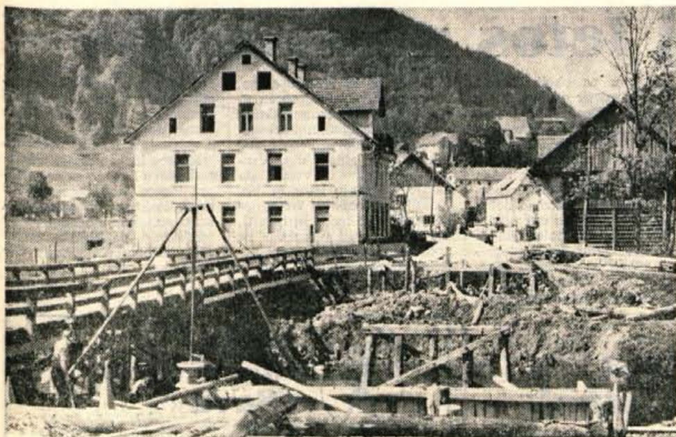
Ziri bodo kmalu — približno do konca julija — dobile nov, 38 metrov dolg betonski most prek Poljanščice. Sredstva zanj je prispeval cestni sklad SRS, dela pa izvaja podjetje Remont gradnje Ziri. — Foto: F. Perdan
