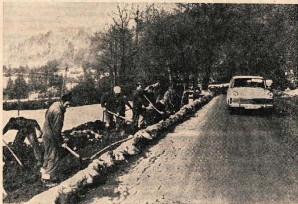
V Mostah pri Zirovnici že pripravljajo zemljišče za rekonstrukcijo nekaterih odsekov gorenjske ceste. — Foto: F. Perdan
